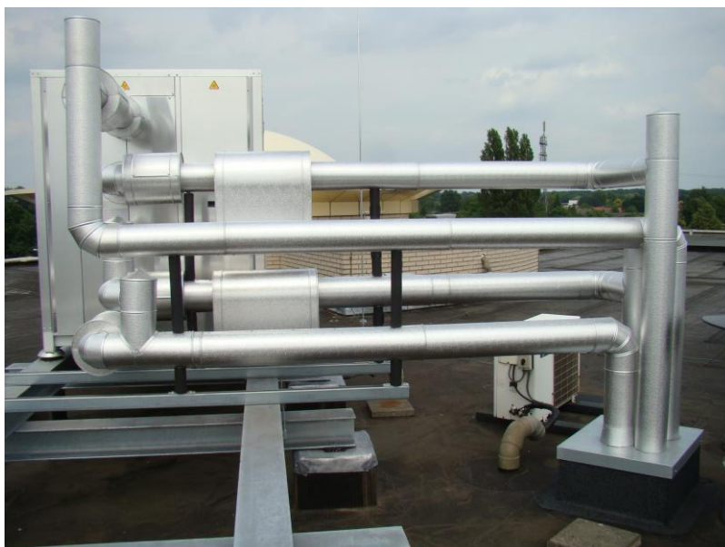
Figuur 1: Warmtepomp unit in combinatie met HR-ketels
