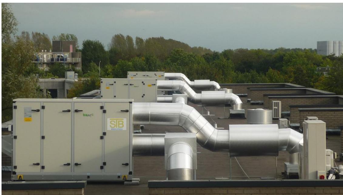
Figuur 10: Ventilatie met warmteterugwin(WTW)-units
