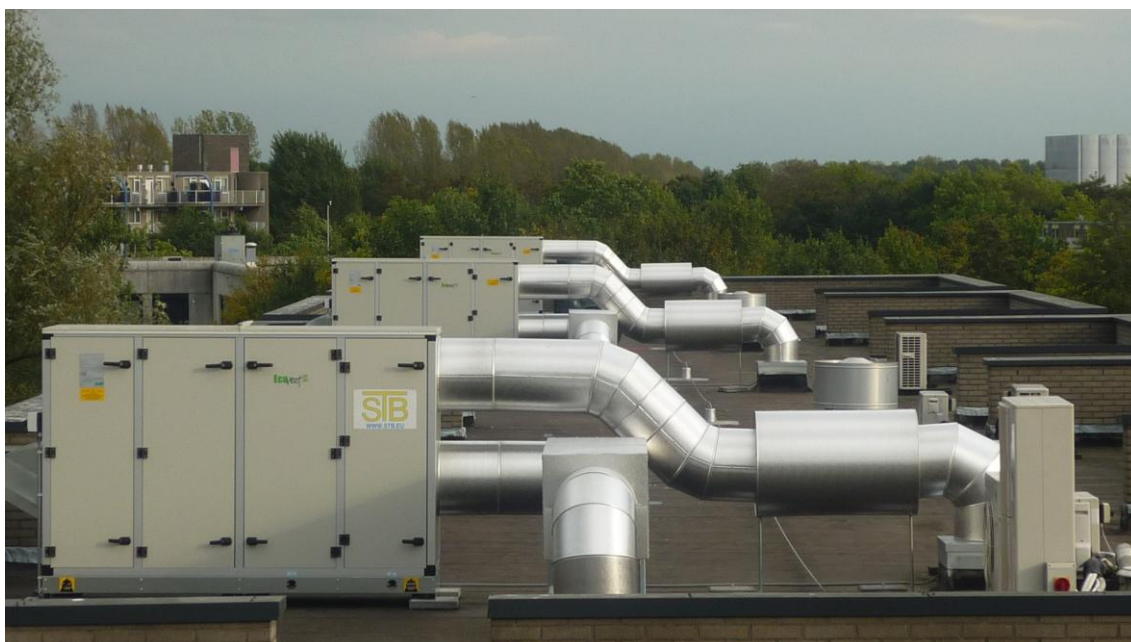
Figuur 11: Ventilatie met warmteterugwin (WTW)-units
