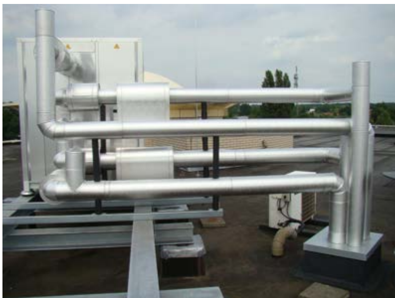
Figuur 1: Warmtepomp unit in combinatie met HR-ketels
