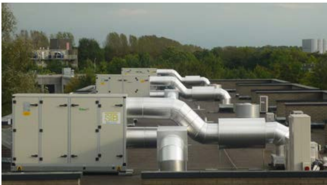
Figuur 11: Ventilatie met warmteterugwin (WTW)-units
